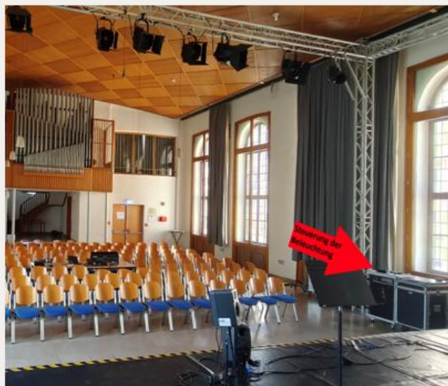
Blick von der Bühne, rechts: Steuerung der Lichttechnik
